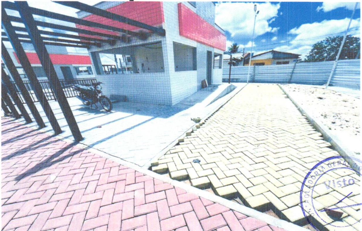
FOTO 42 - EXECUÇÃO DE PASSEIO EM PISO INTERTRAVADO, COM BLOCO RETANGULAR COLORIDO DE 20 X 10 CM, ESPESSURA 6 CM. AF_12/2015
