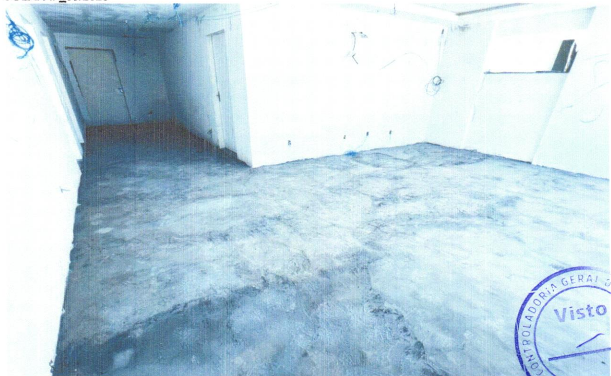
FOTO 06 - PISO VINÍLICO SEMI-FLEXÍVEL EM PLACAS, PADRÃO LISO, ESPESSURA 3,2 MM, FIXADO COM COLA. AF_09/2020
